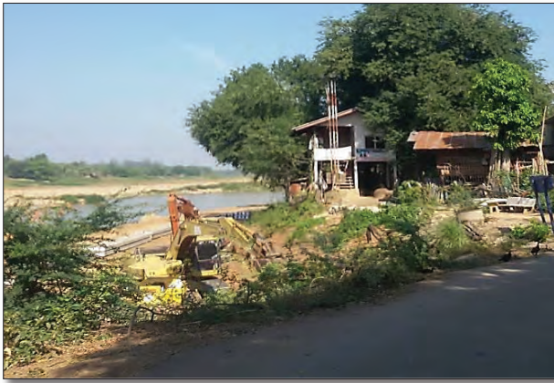
สิ่งปลูกสร้างกีดขวางแนวก่อสร้างเรือถอน
