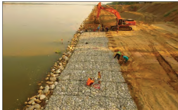
ภาพแสดงกล่องแมทเทรสที่บรรจุหินใหญ่พร้อมแทรกโครงด้วยหินเล็กหน้าเขื่อน และปิดฝาดูจำนวนพร้อมที่จะนำไปติดตั้งที่ตื้นเขิน
