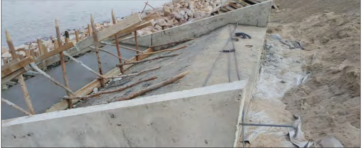
ภาพถ่ายแสดงรอยต่อตัดขาดของคานในแต่ละช่วงต้องตรงตำแหน่ง กันการแตกร้าวภายหลัง
