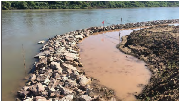
ภาพแสดงทิ้งหินปิดหัว - ท้ายเขื่อนแบบคั่นหินดินเขื่อน
