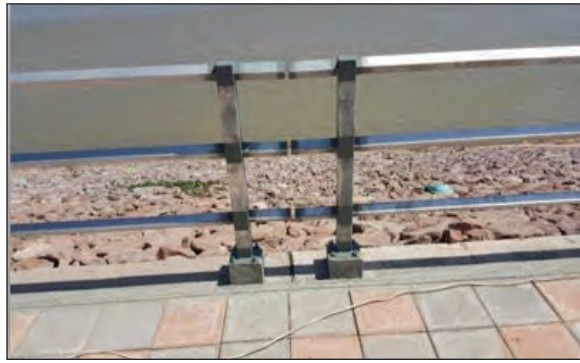
ภาพถ่ายแสดงรอยต่อตัดขาด
