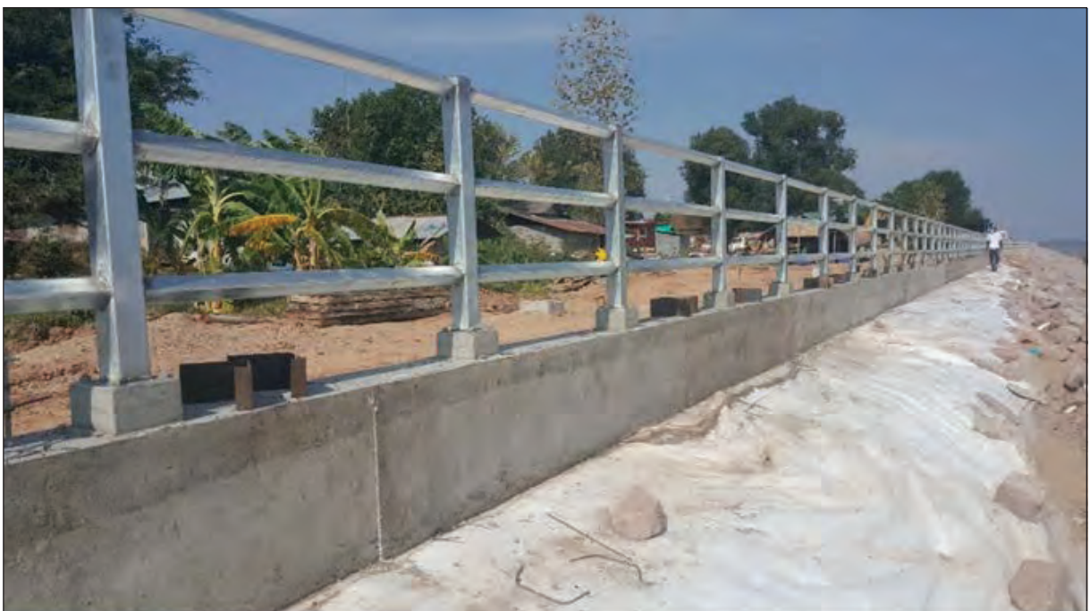
ภาพถ่ายแสดงคานรับราวกันตงเมื่อทำการก่อสร้างแล้วเสร็จ
