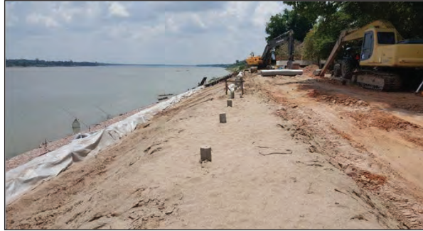
ภาพถ่ายแสดงการตอกเสาเข็ม เสาเข็มแบบหกเหลี่ยมกลวง
