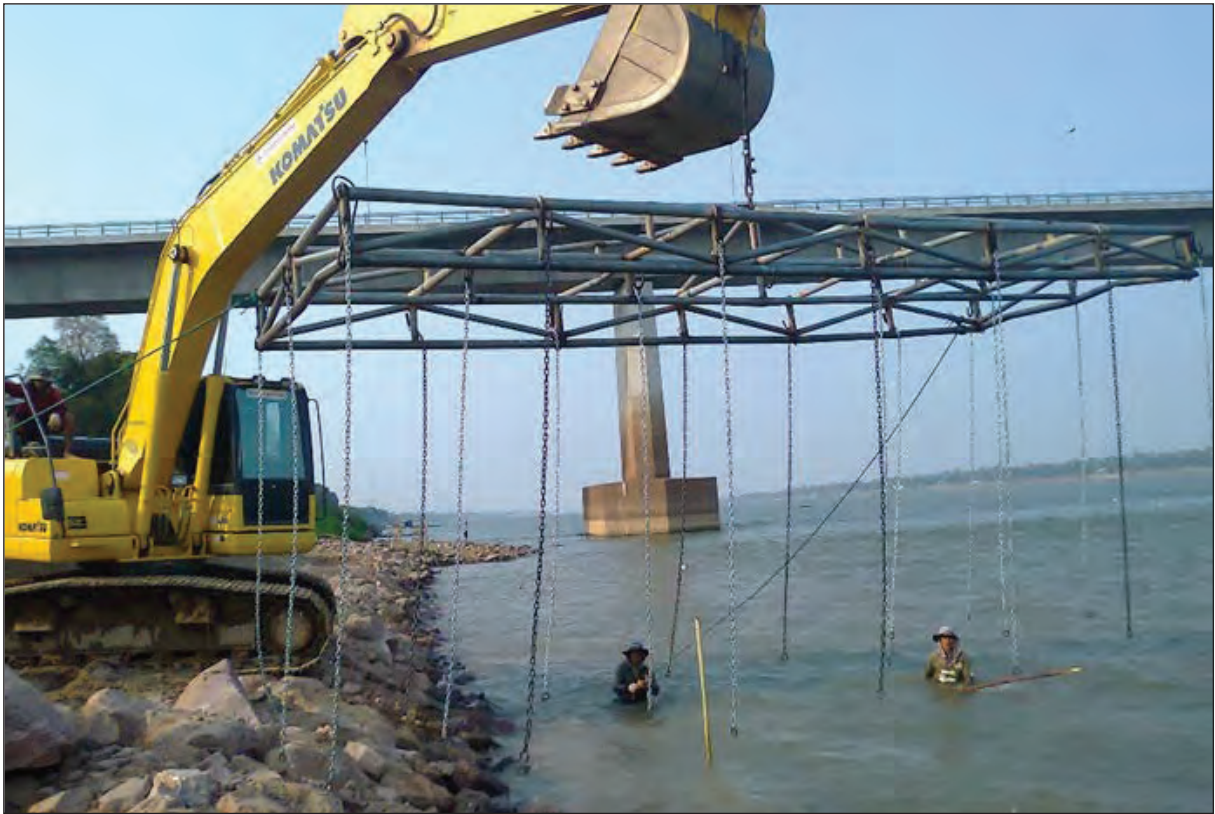
ภาพถ่ายแสดงการยกกล่องเมทเทรสป้ายิ่ง ตำแหน่งติดตั้งที่ตีนเขื่อน
