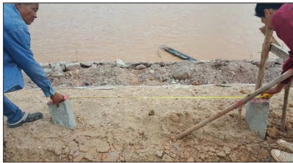
ภาพถ่ายแสดงการตอกเสาเข็ม รอยต่อตัดขาดของคานระยะห่างเสาเข็ม ๒.๐๐ เมตร
