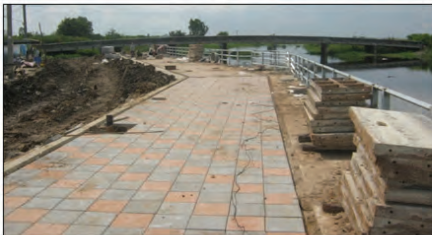
ภาพแสดงงานปูแผ่นพื้นคอนกรีตบล็อกประสานปูพื้น
