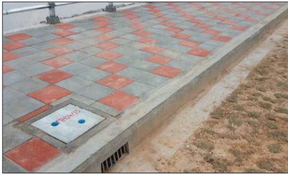
ภาพถ่ายแสดงบ่อพักน้ำและตะแกรงดักขยะ
