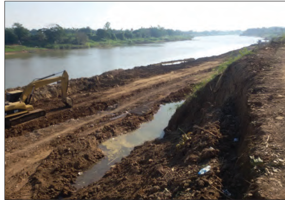
ตรวจพบน้ำใต้ดินบริเวณแนวก่อสร้าง
